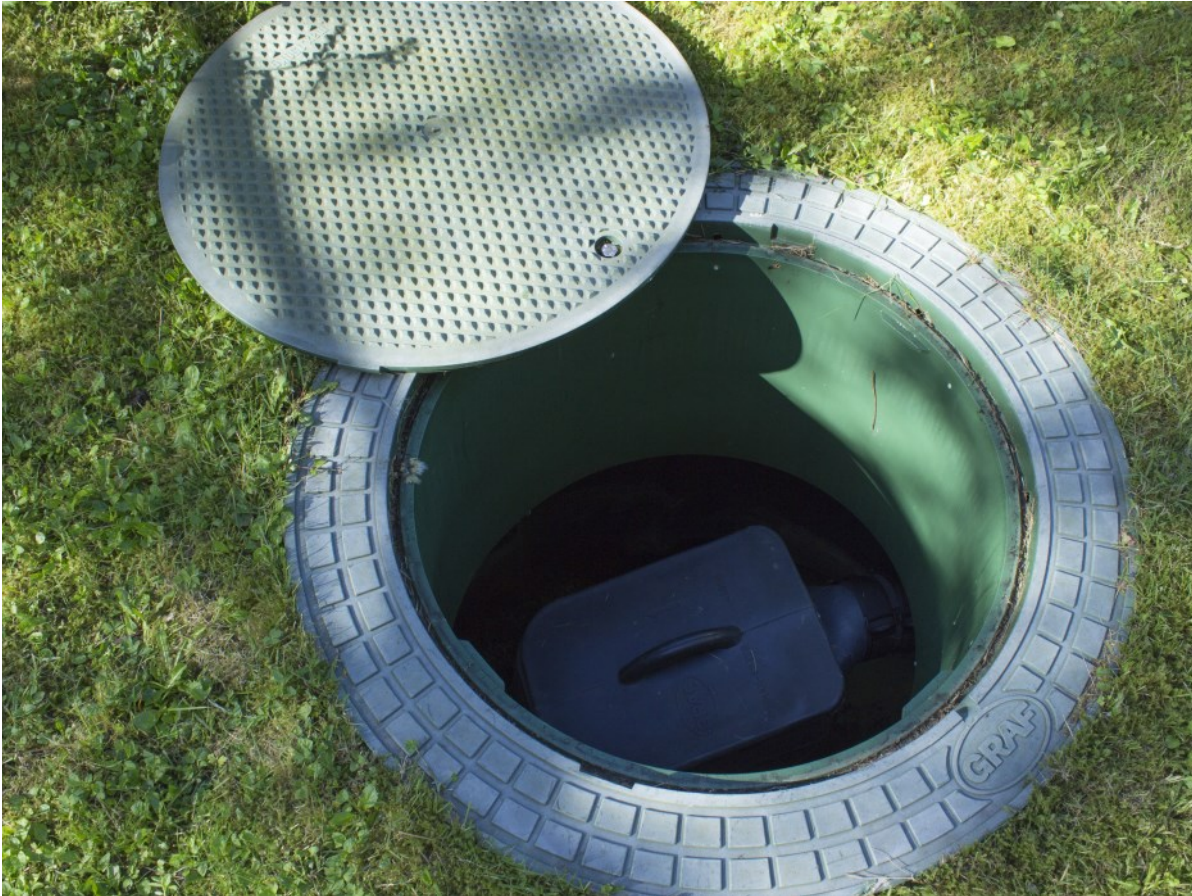
Abbildung 1: geöffnete Zisterne mit 3.000 Litern Fassungsvermögen (eigene Aufnahme ZRK)
